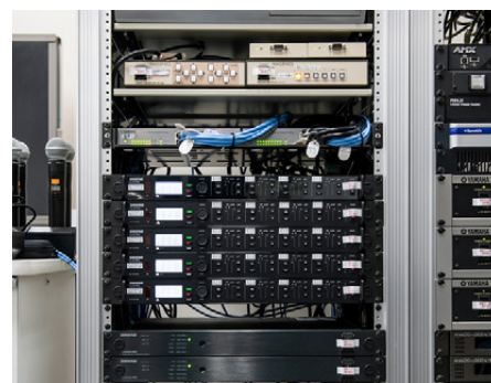
会議室内のラックには誰にでもわかりやすいようにラベルが貼られている。
