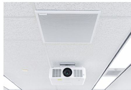
天井の一部のように設置された MXA910
